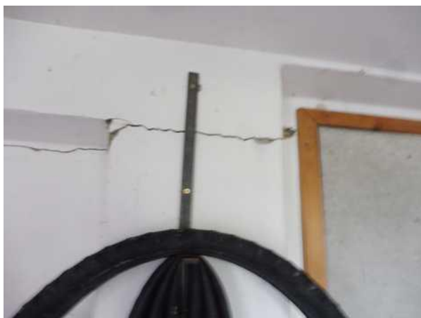
Trhliny v nosném zdivu
